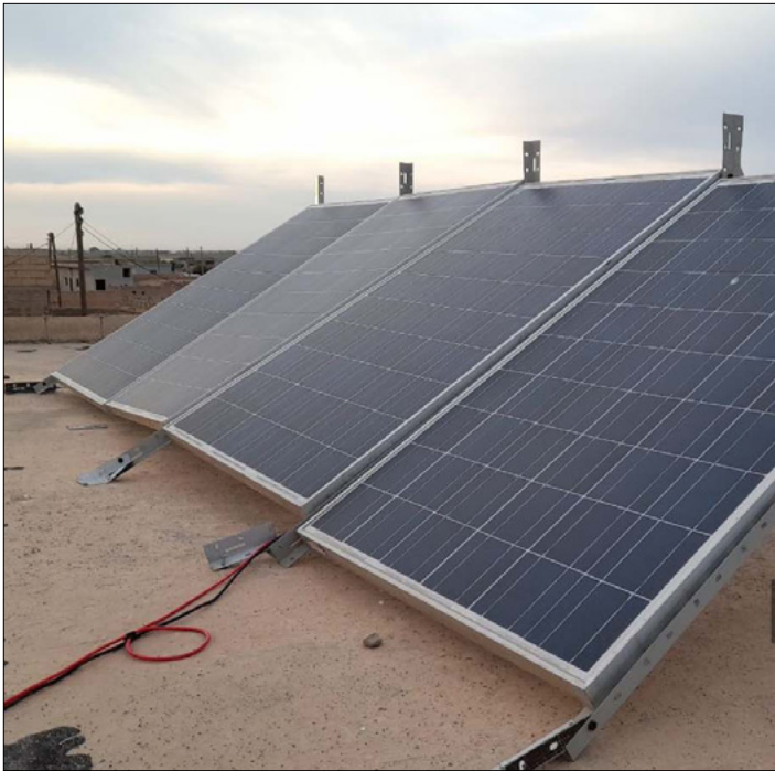
صورة لألواح طاقة شمسية على أسطح أحد منازل الأهالي بالرقّة 28 من آذار 2022 (عنب بلدي/ حسام العمر)
