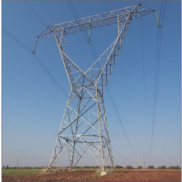
عمود كهرباء للتيار العالي في ريف حمص الشمالي - 7 كانون الثاني 2020 (عنب بلدي عروة المنذر)
